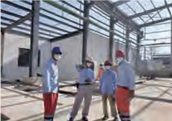
安全總監到動力分廠電修車間進行安全檢查
