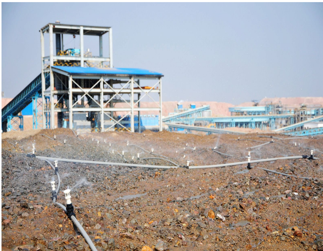
堆浸系统 1#堆场正在喷淋
